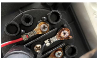
Dysfonctionnement dû à la corrosion
