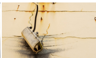
Desserrer l'installation en raison de la corrosion
